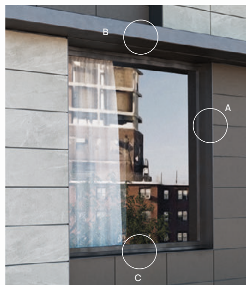
VENTANA CON VIERTTEAGUAS METÁLICO. WINDOW WITH METALLIC SILL. FENÊTRE AVEC APPUI MÉTALLIQUE. ОКНО С МЕТАЛЛИЧЕСКИМ РАЗЛИВОМ.
